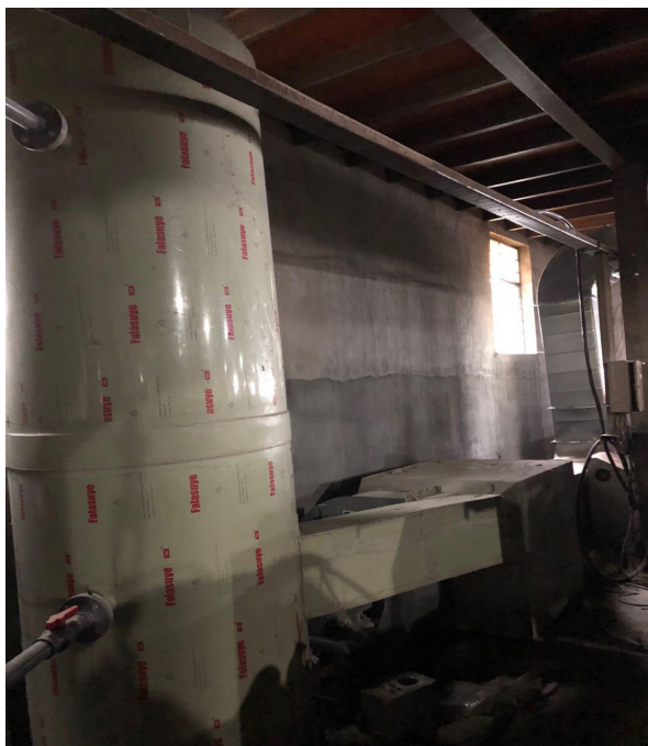
图 4-2 本项目工艺废气治理设施图片
