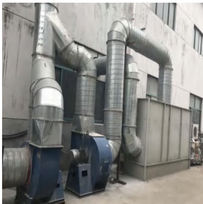
图 4-4 本项目废气治理设施图片
