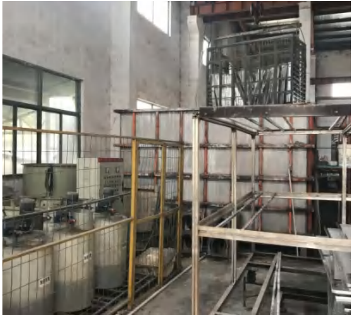
图 4-2 废水处理设施图
